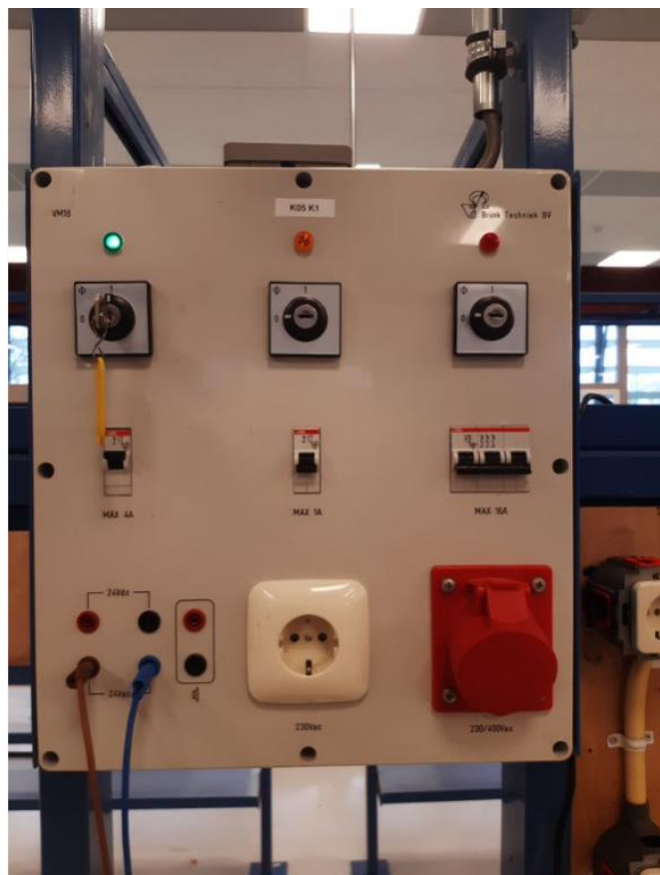
Figuur 67 Het moment is aangebroken dat de bordopdracht, via de toestelcontactdoos, wordt aangesloten op 24V AC (wisselstroom)
